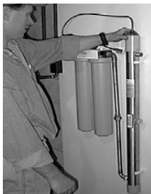
Installation der UV Anlage
